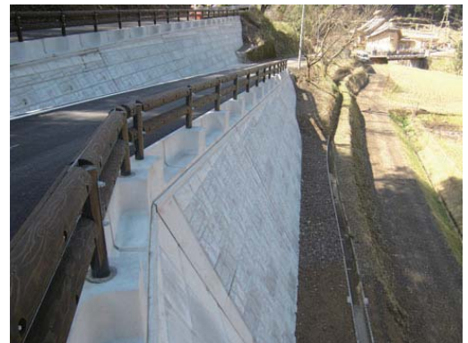
高知県須崎土木事務所四万十町事務所 県道大方大正線社会資本整備総合交付金工事
