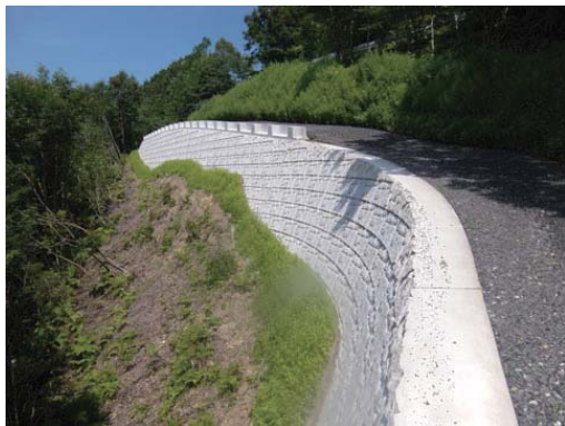
国土交通省 中筋川総合開発工事事務所 横瀬川ダム土捨場進入路外 1 件工事
